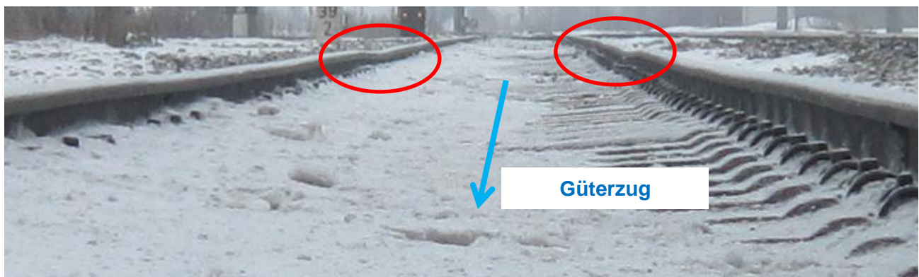
Abbildung 31 Augenscheinliche Gleislagefehler im Bereich der Entgleisungsstelle Detail am 15. Februar 2013, 07:55 Uhr (Quelle SUB)
