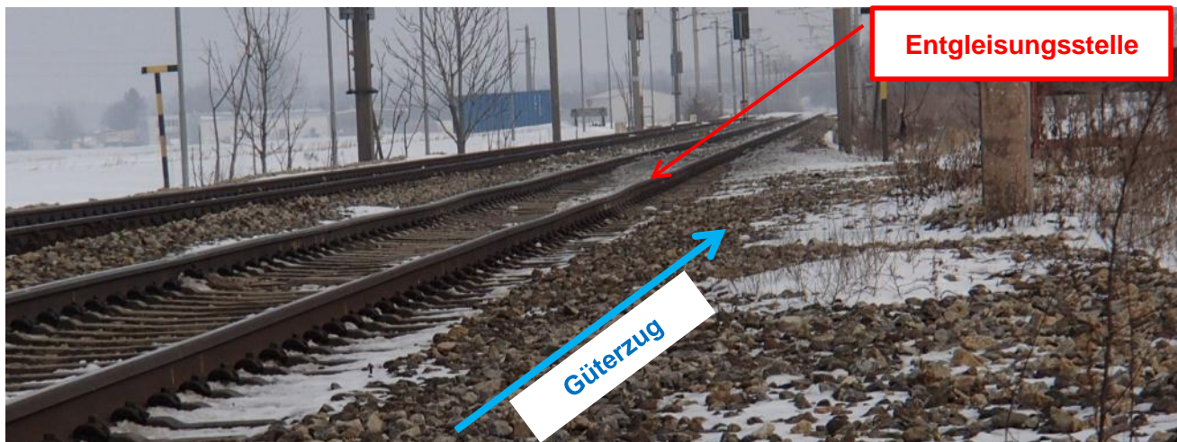
Abbildung 32 Augenscheinliche Gleislagefehler im Bereich der Entgleisungsstelle am 15. Februar 2013, 12:55 Uhr (Quelle IM)
