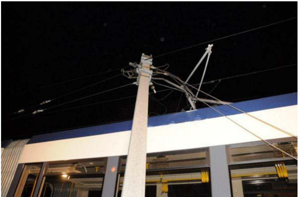
Abbildung 10 Ansicht des geführten Tw mit dem geknickten Mast der Oberleitung - Quelle Feuerwehr Tribuswinkel
