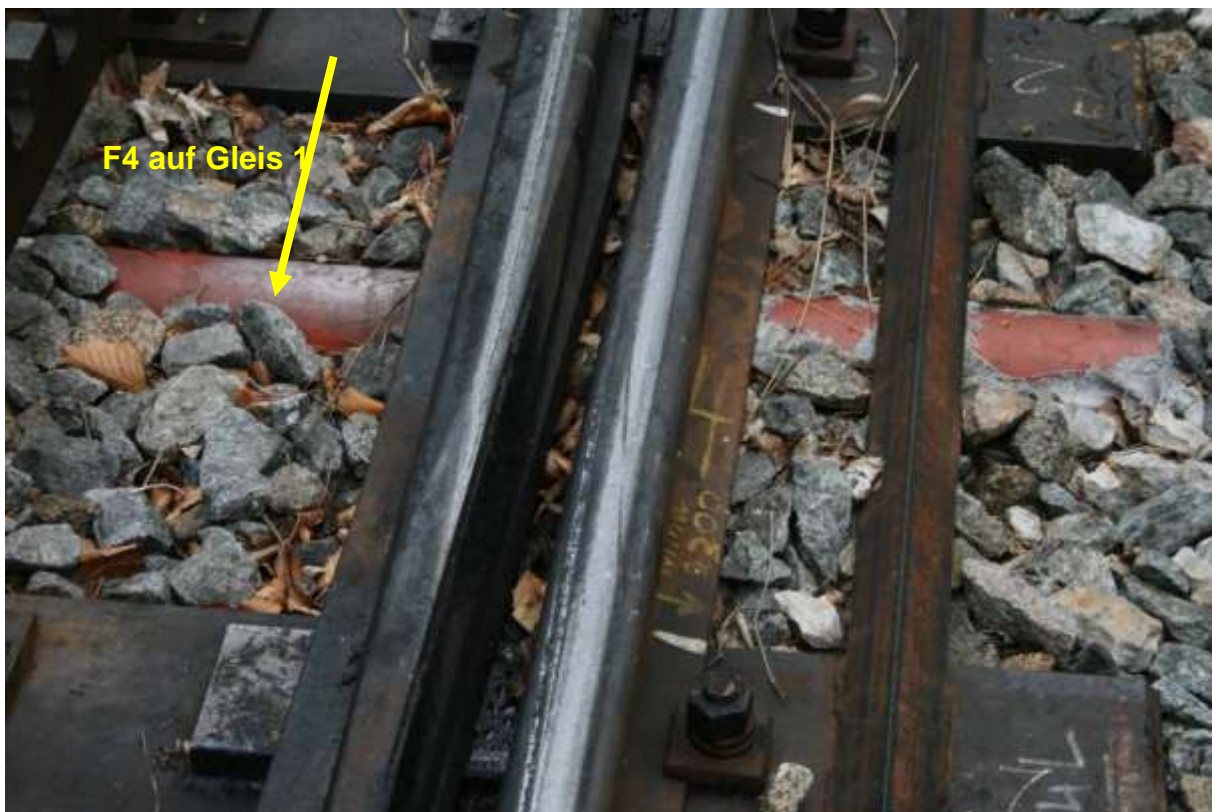
Abbildung 13 Weiche 1 – Stellung Durchfahrt auf Gleis 1 - Entgleisungsspuren
