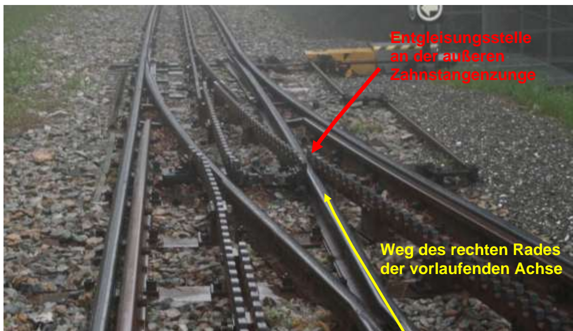
Abbildung 8 Aw Wasserstelle am Hengst – Weiche 1 in Fahrtrichtung F4 - Detail
