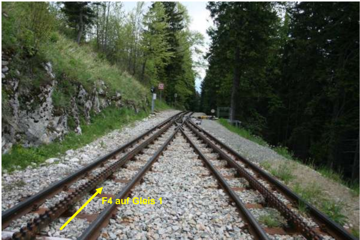
Abbildung 15 Weiche 1 – Richtung Puchberg am Schneeberg innerhalb des Achszählabschnittes
