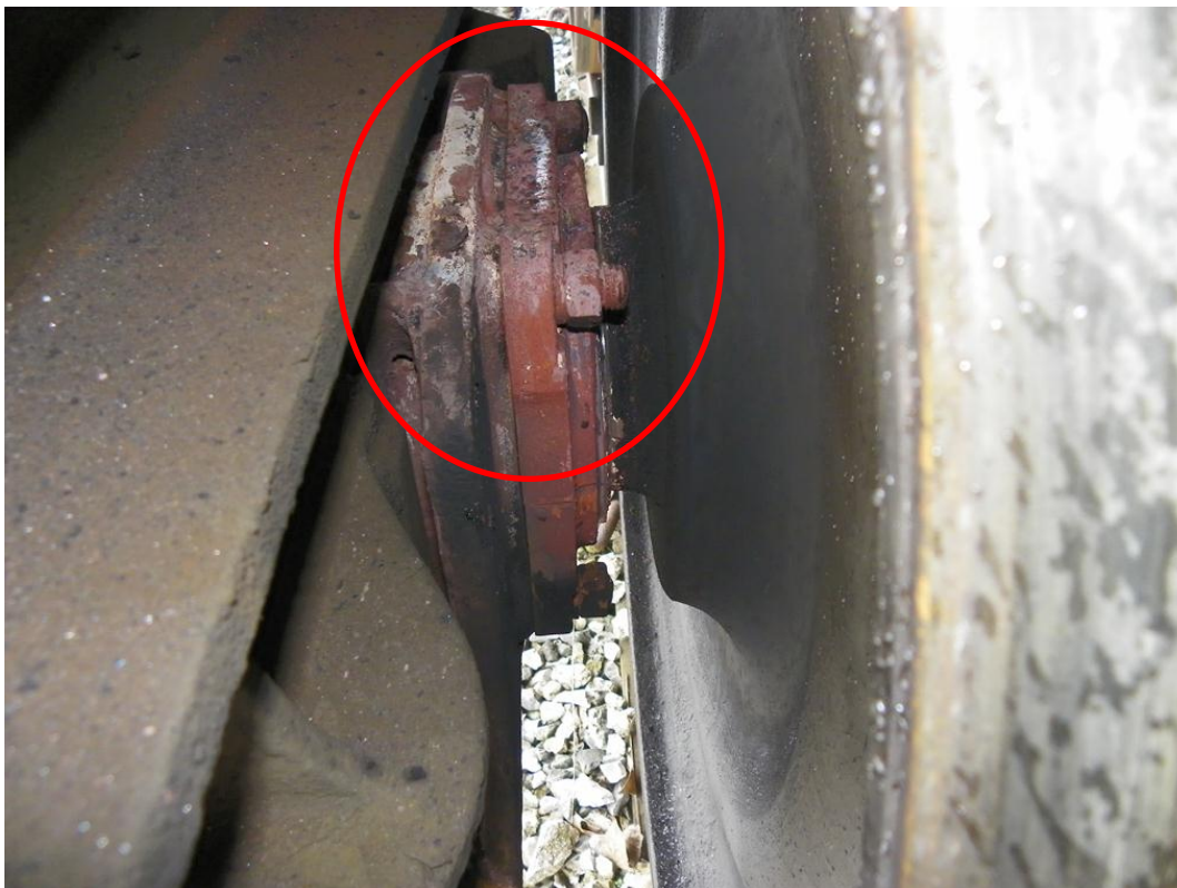
Abbildung 9 Wagen Zas – Detail Brandspuren an der Innenseite des Radsatzlager (Quelle RU)
