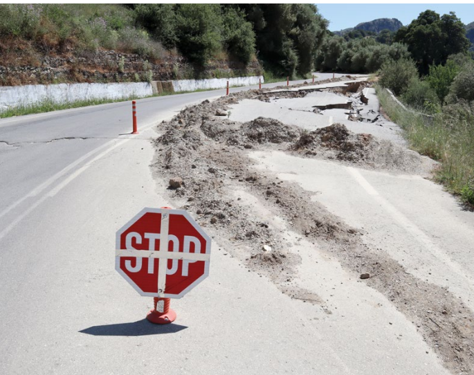
Abbildung 1: Straßenschäden nach Unwetter. Foto: Umweltbundesamt/ B. Gröger
