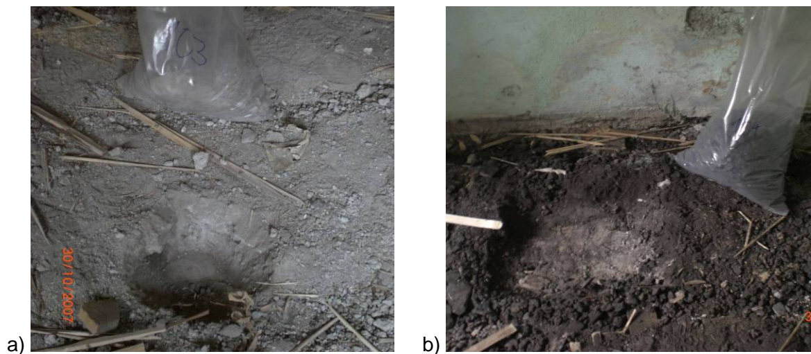
Abbildung 3-13: Probenahme von den mineralischen Deckenschüttungen; a) die Entnahme über der Tramdecke im Raum 104; b) die selektive Entnahme der dunklen Deckschicht in Raum 103
