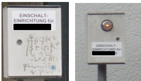
Abbildung 14 Unterschiedliche ortsfeste Empfangsanlagen für Fernbediengeräte durch den Tzfz für EKSA (Quelle SUB)
