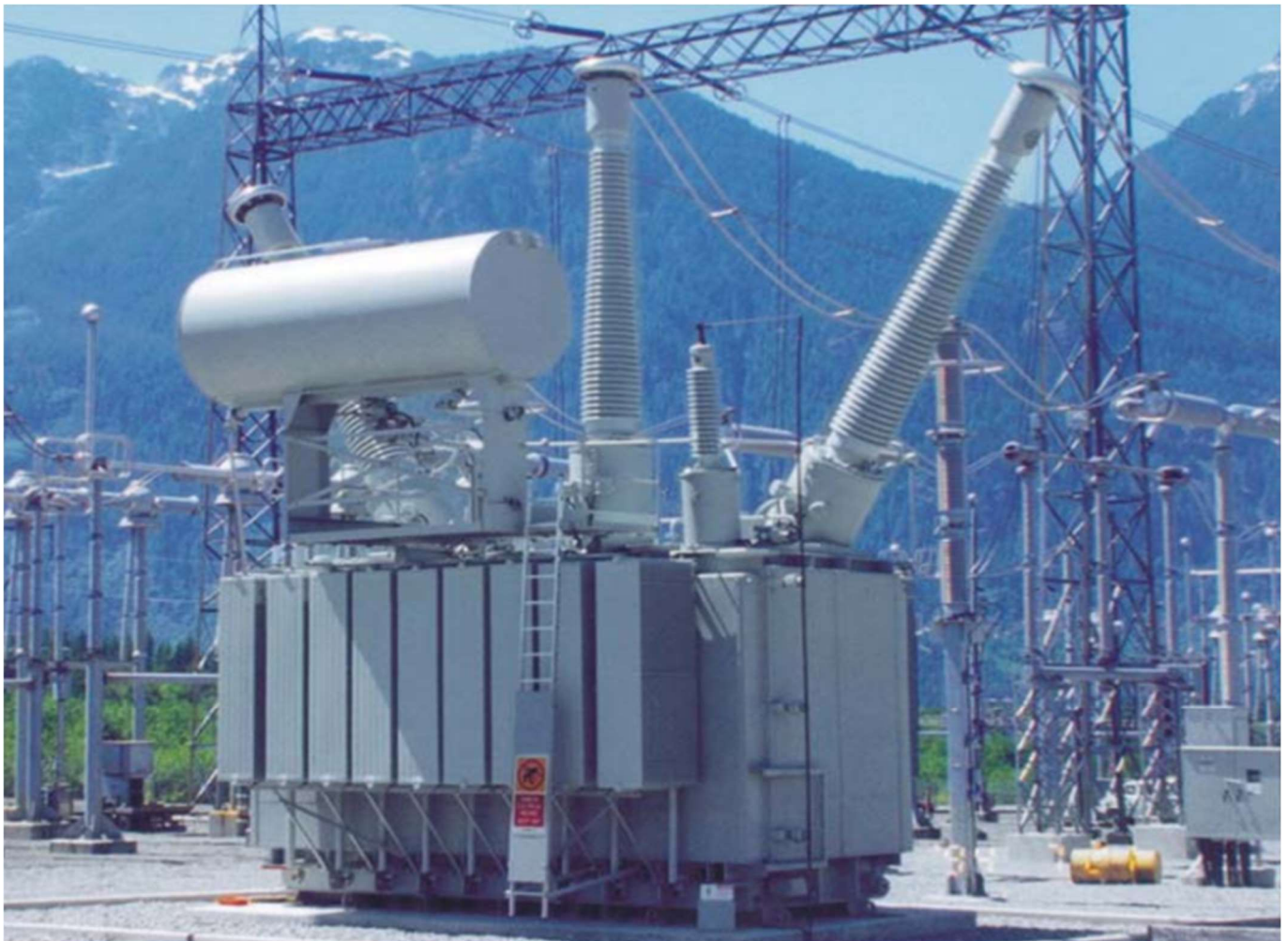
Abbildung 27: Blindleistung Kompensationsdrosselspule (Quelle: Siemens)
