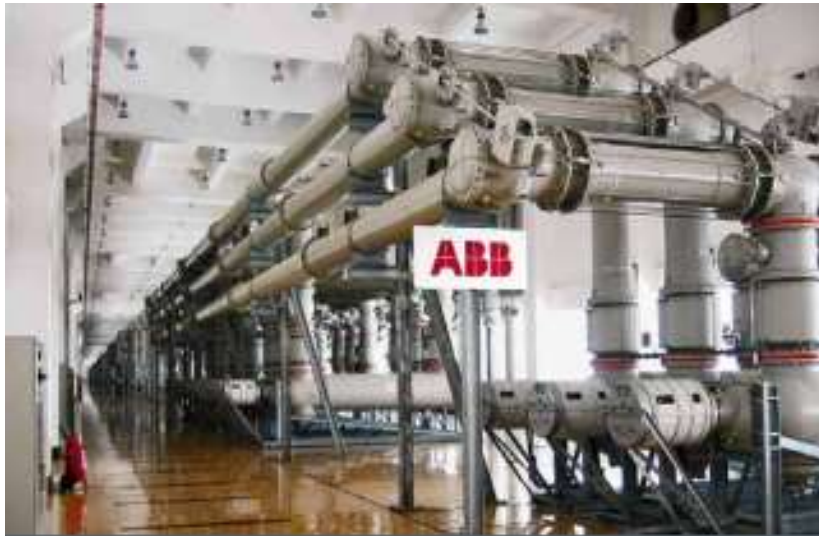
Abbildung 49: Beispielaufbau einer 550-kV-Unterstation mit GIS (550 kV, 63 kA, 4.000 A) im Inneren des Drei-Schluchten-Damms (Heinemann & Besold, 2009)
