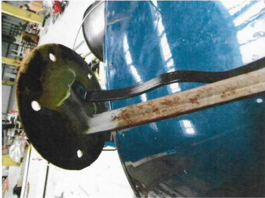
Bild 7: Korrosion am gesamter Halterung Tankfüllstandsgeber (Quelle: Auftraggeberin)
