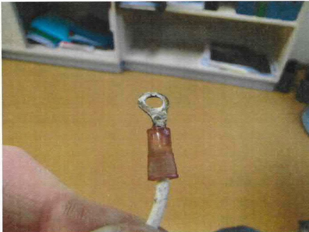
Bild 9: Korrodierter Kabelschuh (Quelle: Auftraggeberin)
