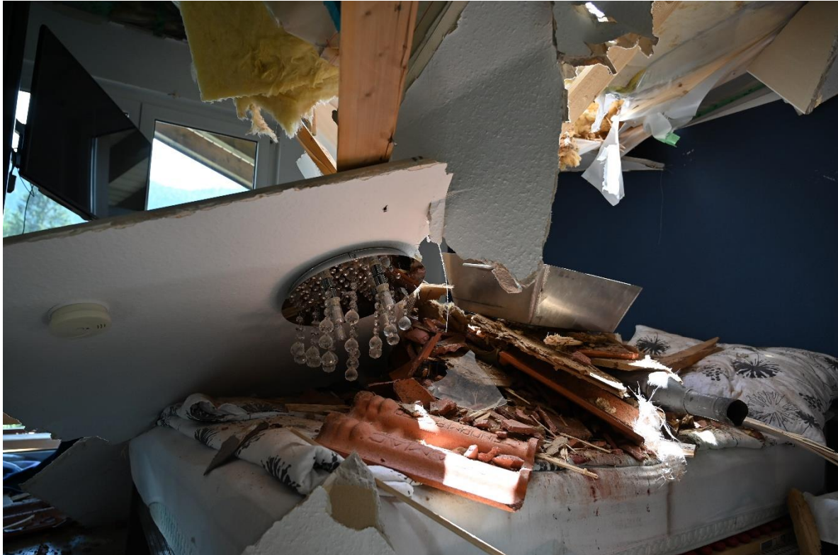
Abbildung 2 Zimmer unterhalb der Einschlagstelle des Luftfahrzeuges im Dach
