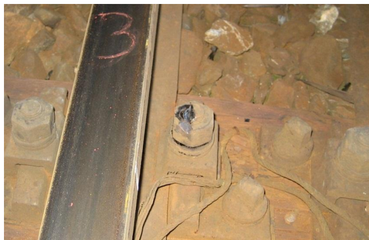
Abbildung 7 Beschädigte Befestigungsschrauben - Quelle [1]
