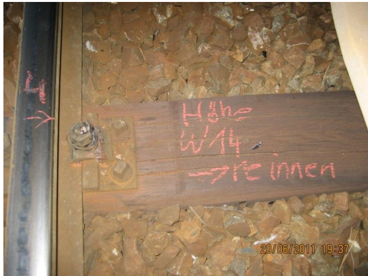
Abbildung 8 Entgleisungsspuren am linken Schienenstrang - Quelle [1]
