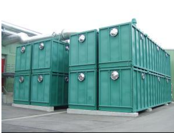
Abbildung 8-2: Container-Biofilter mit Ableitung der Abluft als geführte Punktquelle
