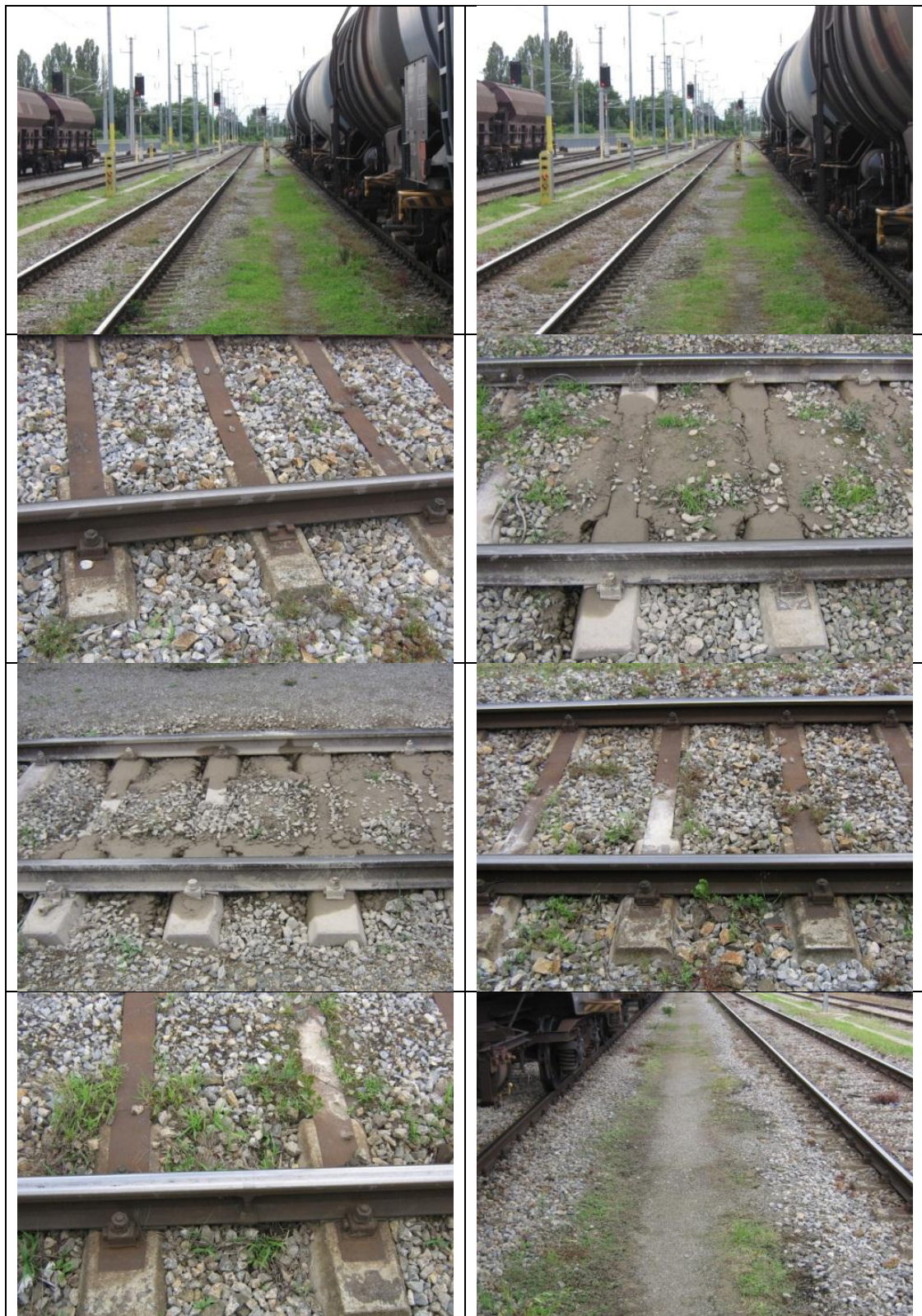
Abbildung 11 Bilder 2 des Gleiszustandes vom 11. Juni 2012 - Quelle Wagenmeister
