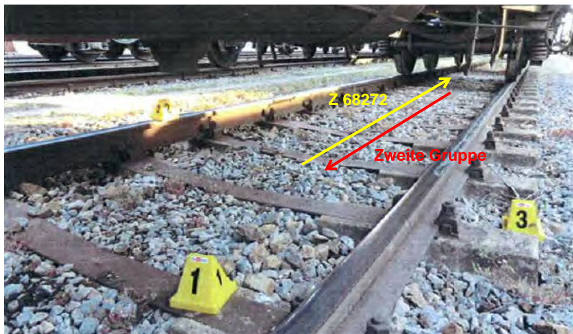
Abbildung 17 Bereich der Entgleisungsstelle km 18,398 - Quelle IM
