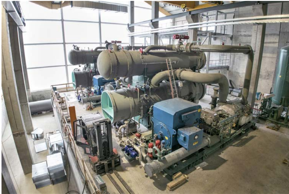
Abbildung 8 Foto einer Großwärmepumpe zur Fernwärmeerzeugung in der Kläranlage Wien; Foto: Wien Energie.
