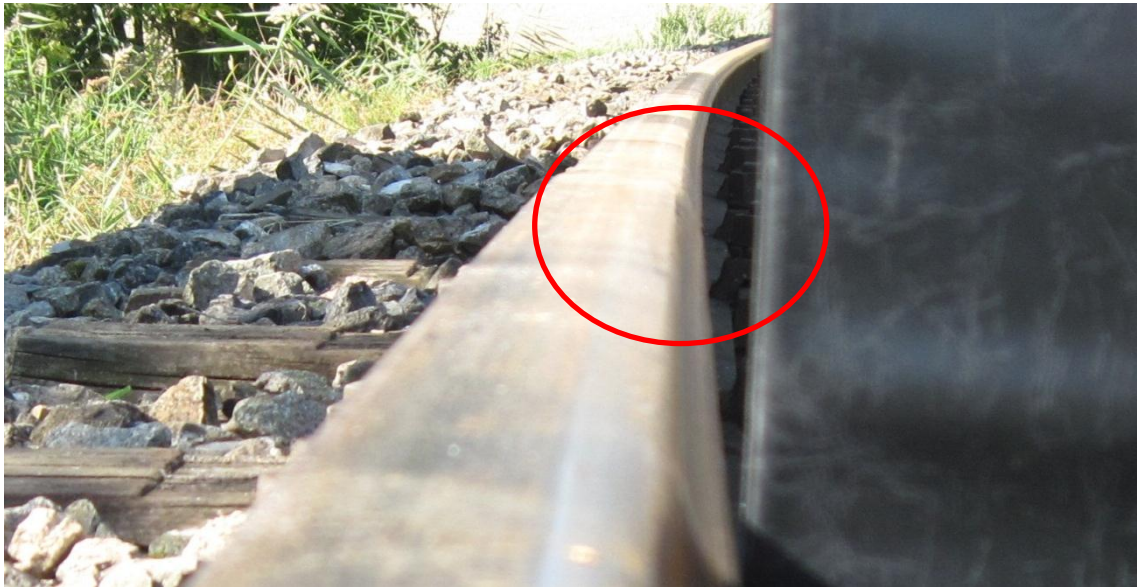
Abbildung 60 Schweißstoß im km 22,910 – Ansicht in Fahrtrichtung - Quelle IM
