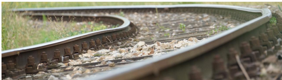
Abbildung 26 Gleislage vor dem gewölbten Durchlass - Quelle Hilfszug
