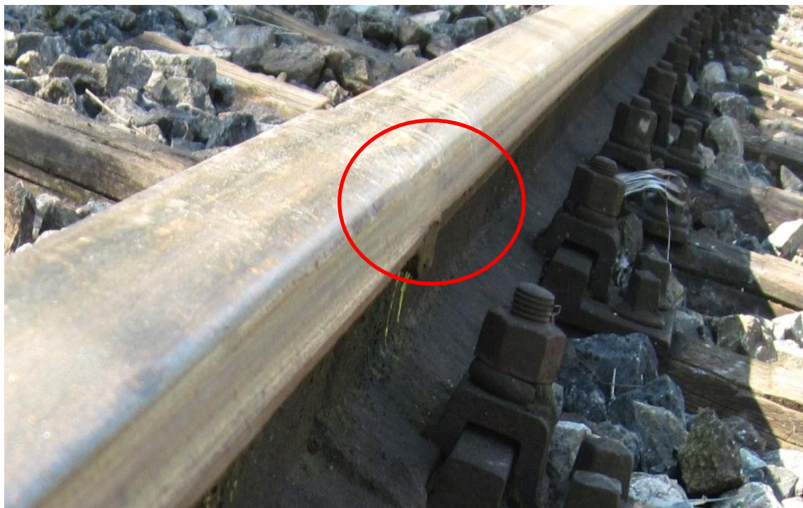
Abbildung 59 Schweißstoß im km 22,910 - Quelle IM
