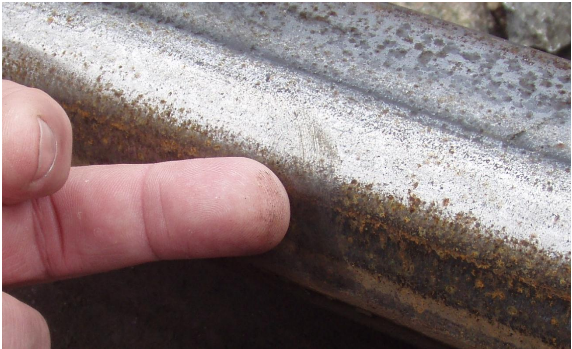
Abbildung 62 Unzureichender Schmierzustand der Fahrkante im Bereich der Entgleisungsstelle
