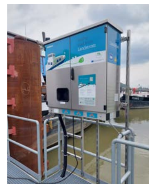
Landstromanlage bei der öffentlichen Lände Linz, Bild: BMK
