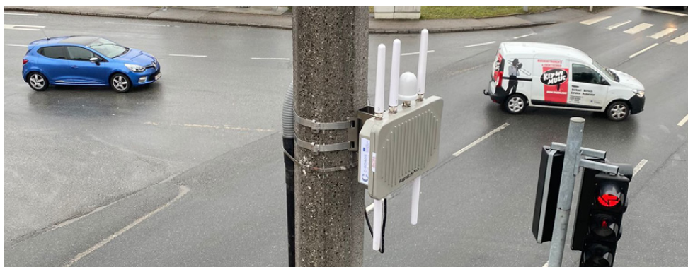
Abbildung 14: Installierte RSS in Salzburg © Salzburg Research
