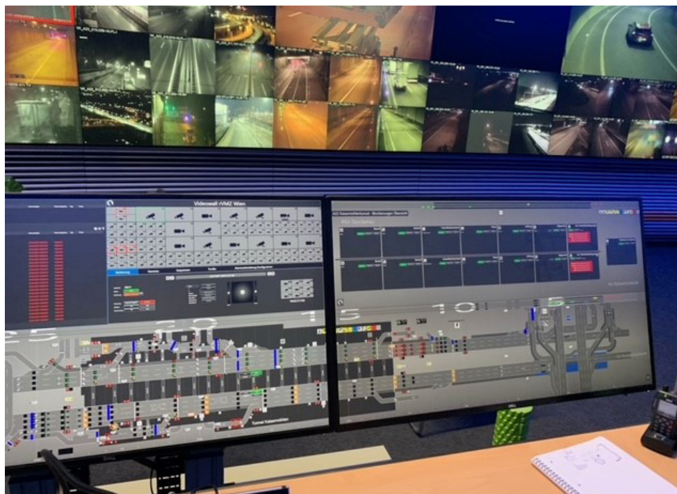
Abbildung 6: VMIS 2.0 Arbeitsplatz von Operatorinnen und Operatoren © ASFINAG
