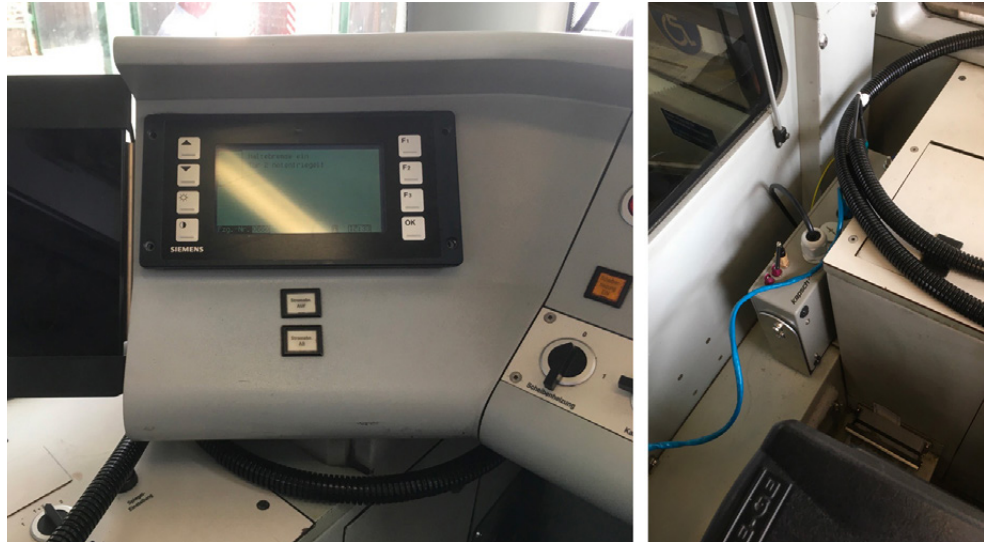
Abbildung 13: In einer Straßenbahn verbaute Onboard-Unit und ein Display zur Visualisierung von C-ITS-Daten der Firma Kapsch © Wiener Linien
