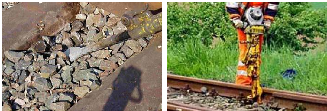
Abbildung 44 Wacker-Stopfer - Quelle Interessengemeinschaft Mainschleifenbahn e.V.
