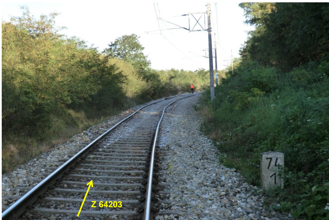
Abbildung 21 Ansicht 1 der Gleislage der Entgleisungsstelle - Quelle RU
