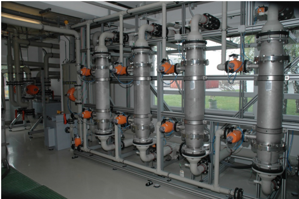
Abbildung 6: Filtriereinheit der Ultrafiltrationsanlage
