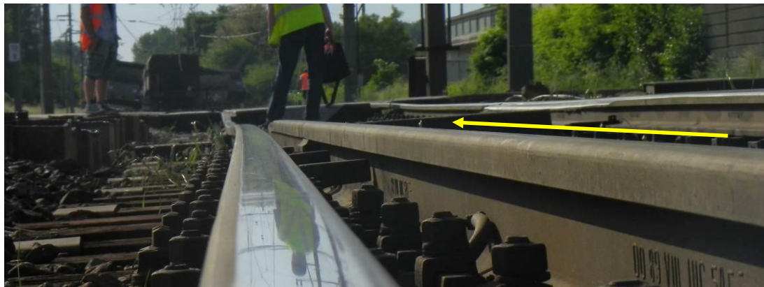
Abbildung 28 Gleisabsenkung linker Schienenstrang - Quelle RU
