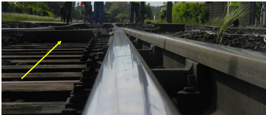
Abbildung 29 Gleisabsenkung rechter Schienenstrang - Quelle RU
