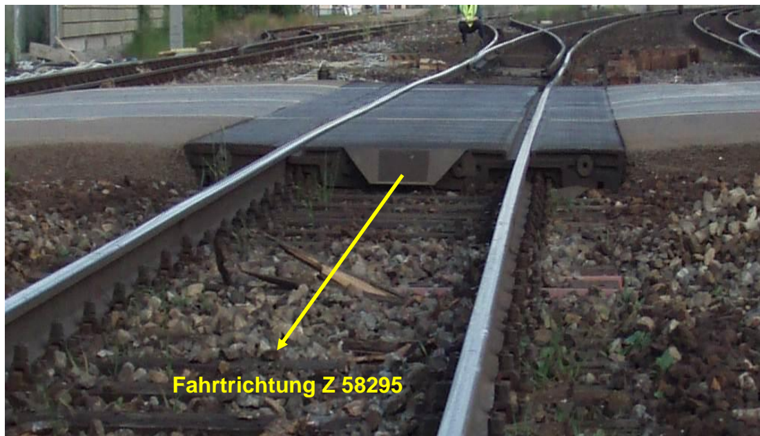
Abbildung 25 Ansicht der Entgleisungsstelle vor EK km 19,727 gegen Fahrtrichtung
