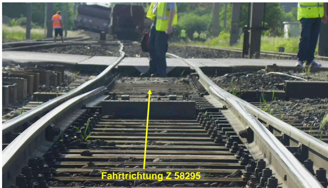
Abbildung 26 Ansicht der Entgleisungsstelle vor EK km 19,727 in Fahrtrichtung
