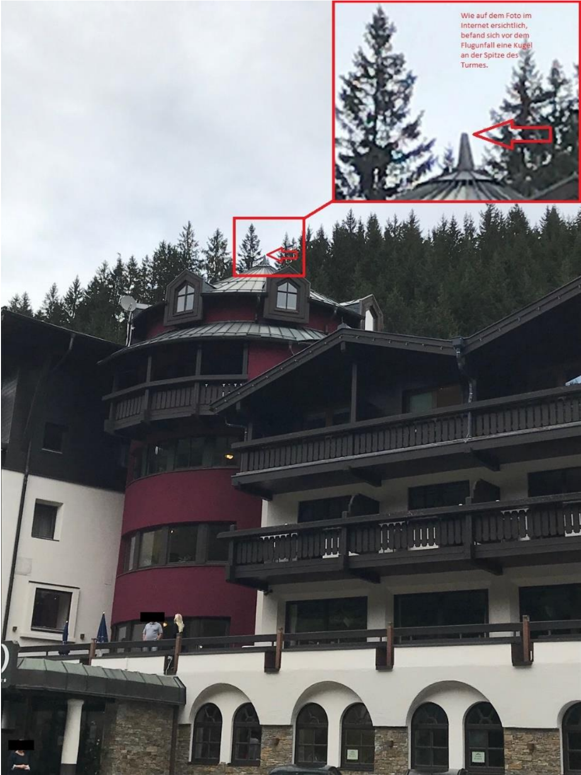
Abbildung 2 Fotos des Hotels im Internet ( https://www.passthurn.at/ ) zeigten vor dem Unfall eine Messingkugel an der Dachspitze des Turmes, welche nach dem Unfall fehlte (Foto).
