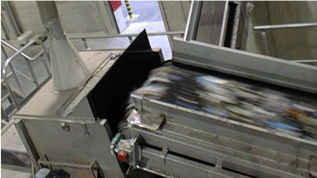
Abbildung 3.5: Übergabestelle und Austragsband, Bürstensichter ausgebaut
