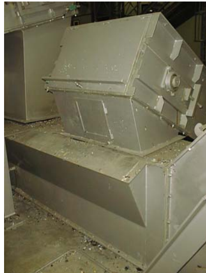
Abbildung 3.6: Übergabestelle hinter der 2D-Nachzerkleinerung, Probenahmeort
