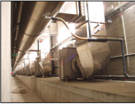
Ventilatoren für Tunnelzuluft
