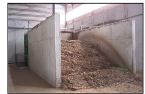
Zwischenbunker mit Schubboden
