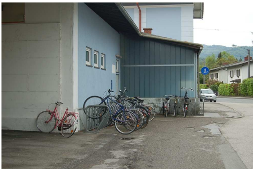
Beispiel für eine mangelhafte Überdachung einer Fahrradabstellanlage, das Vordach bietet keinen Witterungsschutz
