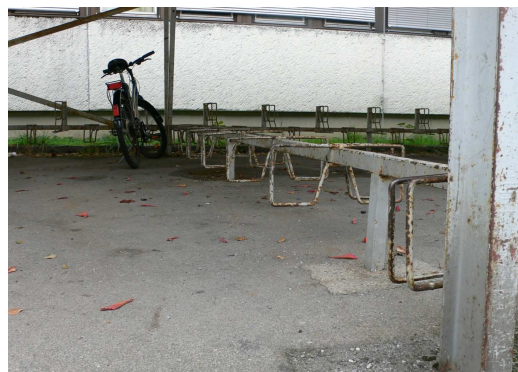
trostloses Erscheinungsbild der Abstellanlage inkl. mangelnder Abstellsysteme
