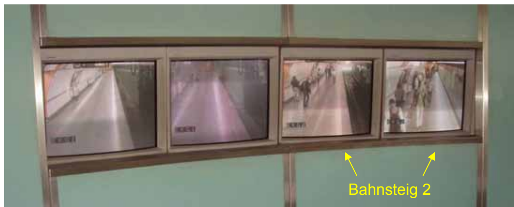
Abbildung 15 Monitore der Bahnsteigüberwachung Station Enkplatz
