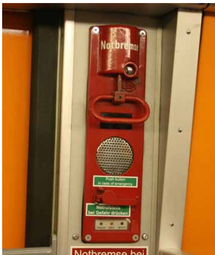
Abbildung 9 Notbremse im HW 3060 neben Tür 11
