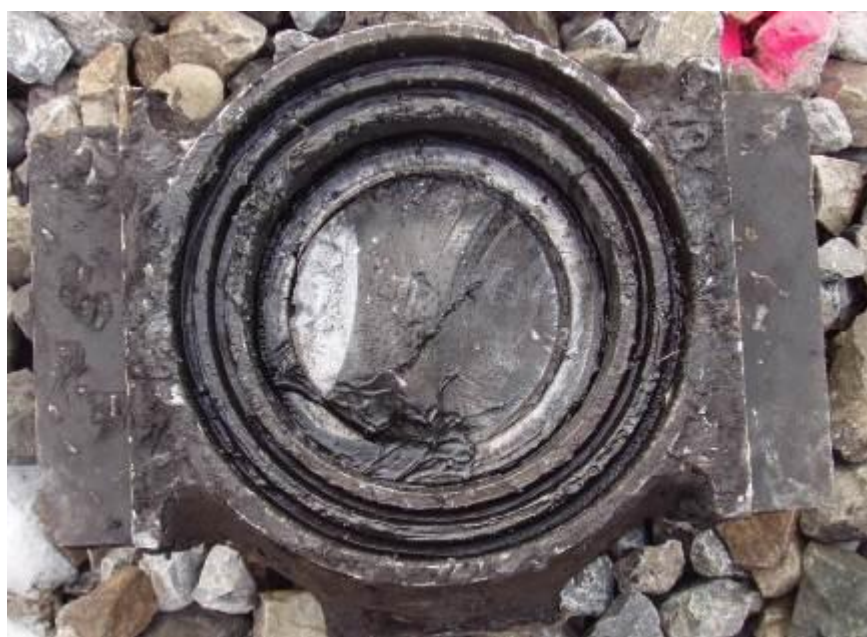
Abbildung 10 Bruchstück im km 14,398
