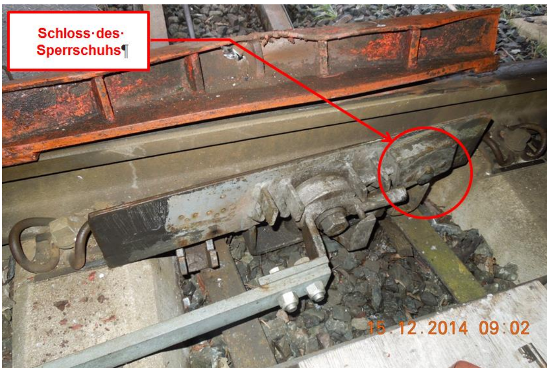
Abbildung 12: Beschädigter noch abgesperrter Sperrschuh „1H“ (Quelle IM ÖBB)
