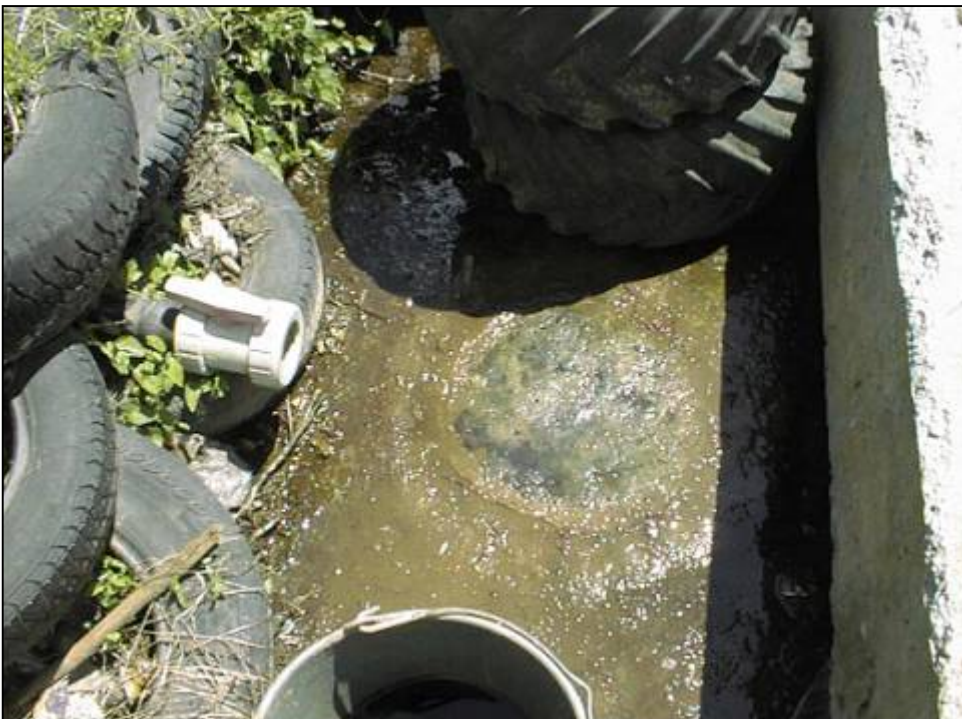
Abbildung 4.12: offenes Sickerwasserleitungsventil vor der Bewässerung, Komp. 2
