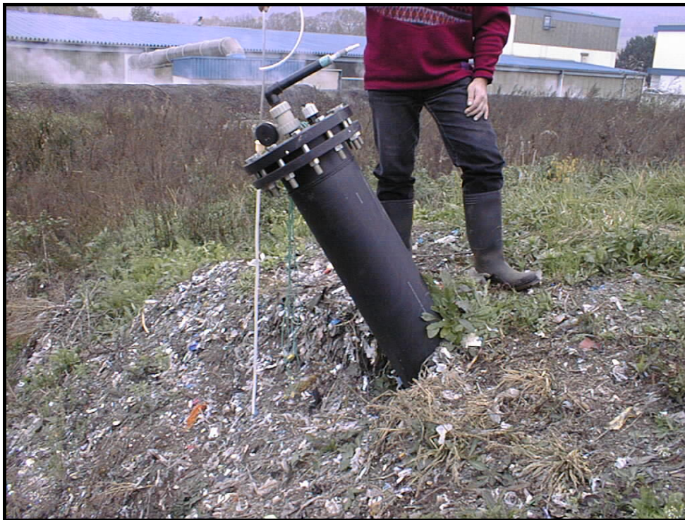
Abbildung 4.1: Richtung Böschung geneigter Gasbrunnen (35° Neigungswinkel)
