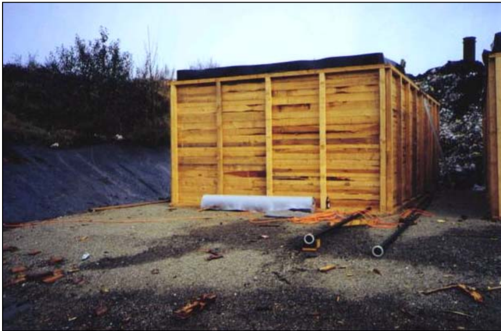
Abbildung 2.5: Kompartiment mit Sickerwasserleitungen
