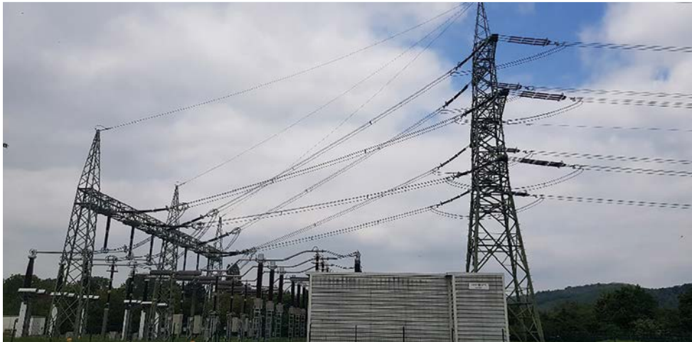
Abbildung 82: Beispiel einer 380-kV-Kabel- übergabestation; Foto: Öster- reichische Energieagentur
