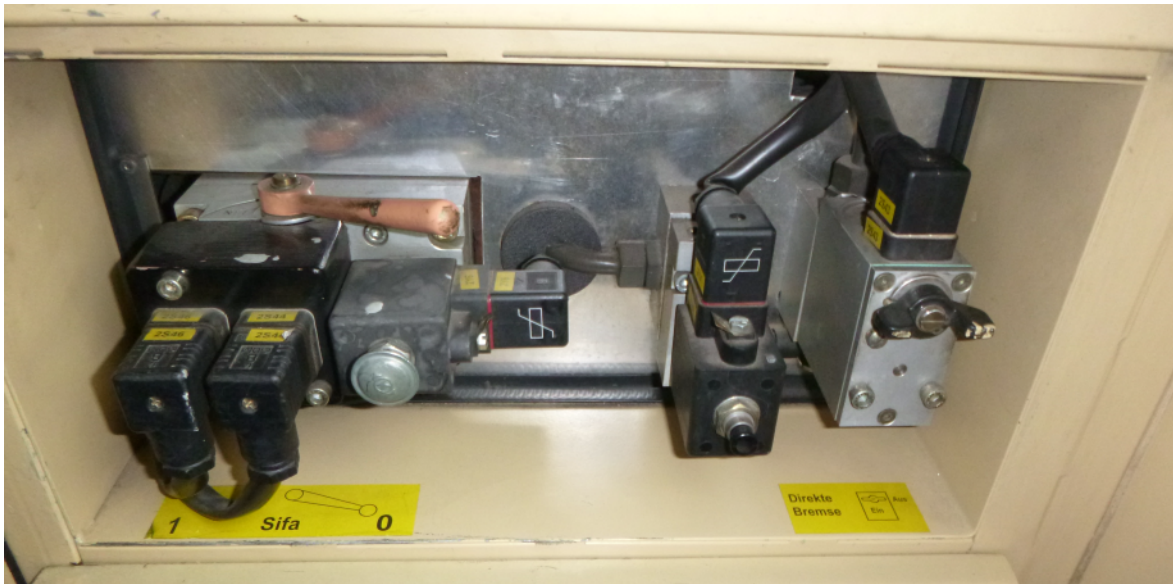
Abbildung 22 Ansicht des SIFA Absperrhahns und der ZuBas
