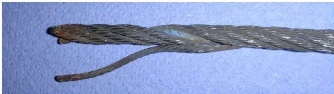
Bild 12: (DSCN5397.JPG) Freigelegtes Einlagenstück (bläulicher Teil) vom Schadensseil. Die herausgedrehte Litze wurde danach wieder in den Seilverband zurückgelegt.
