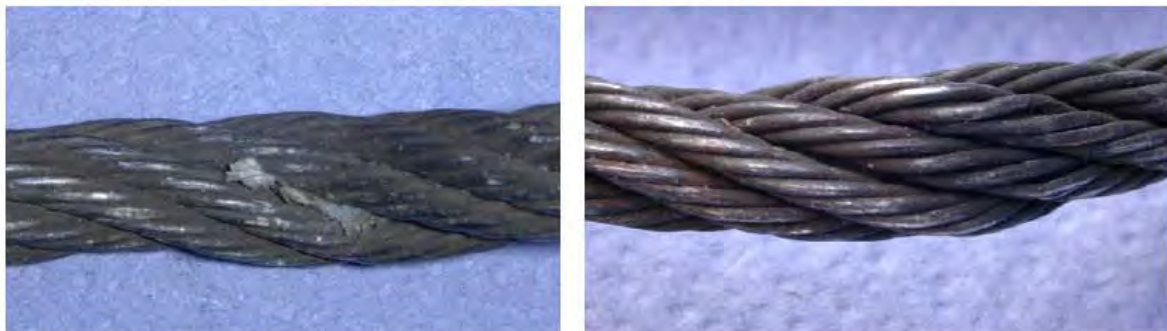
Bild 8: (DSCN5567/69.JPG) Seiloberfläche an der Innenseite (links) und Außenseite (rechts) der Knickstelle (Pos. 2)
