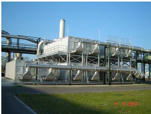
Luftwäscher mit Biofilter in Containerbauweise
