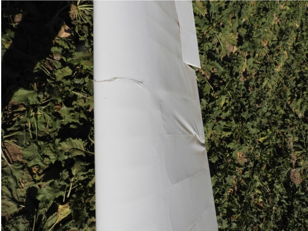
Abbildung 11: gebrochene Endleiste und Eintrittskante
