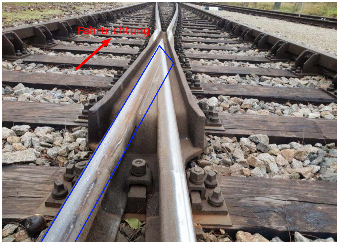
Abbildung 6 Erste Entgleisungsspuren im Weichenherz
