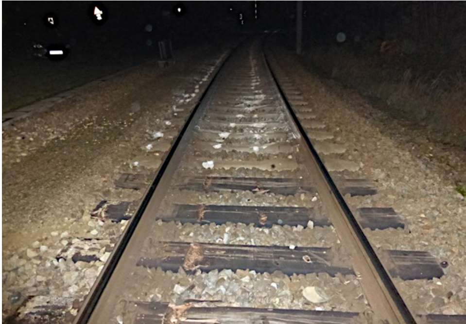
Abbildung 7 Schäden durch Entgleisung am Oberbau
