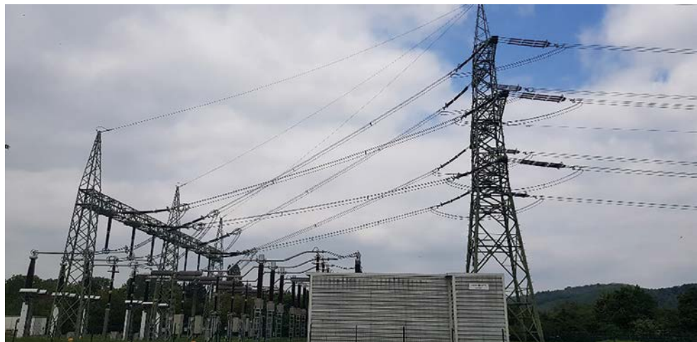
Abbildung 92: Beispiel einer 380-kV-Kabel- übergabestation; Foto: Österreichische Energieagentur
