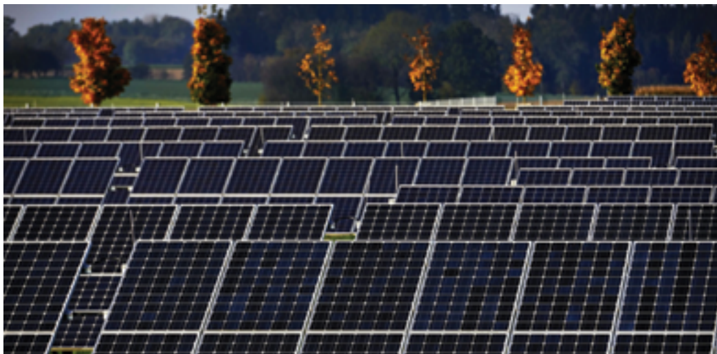
Abbildung 135: Ausgediente Photovoltaikanlagen sind gemäß Abfallbehandlungspflichtenverordnung zu behandeln.
