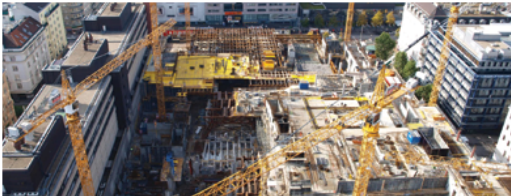
Abbildung 97: Bauaktivitäten verursachen beträchtliche Abfallmassen.
