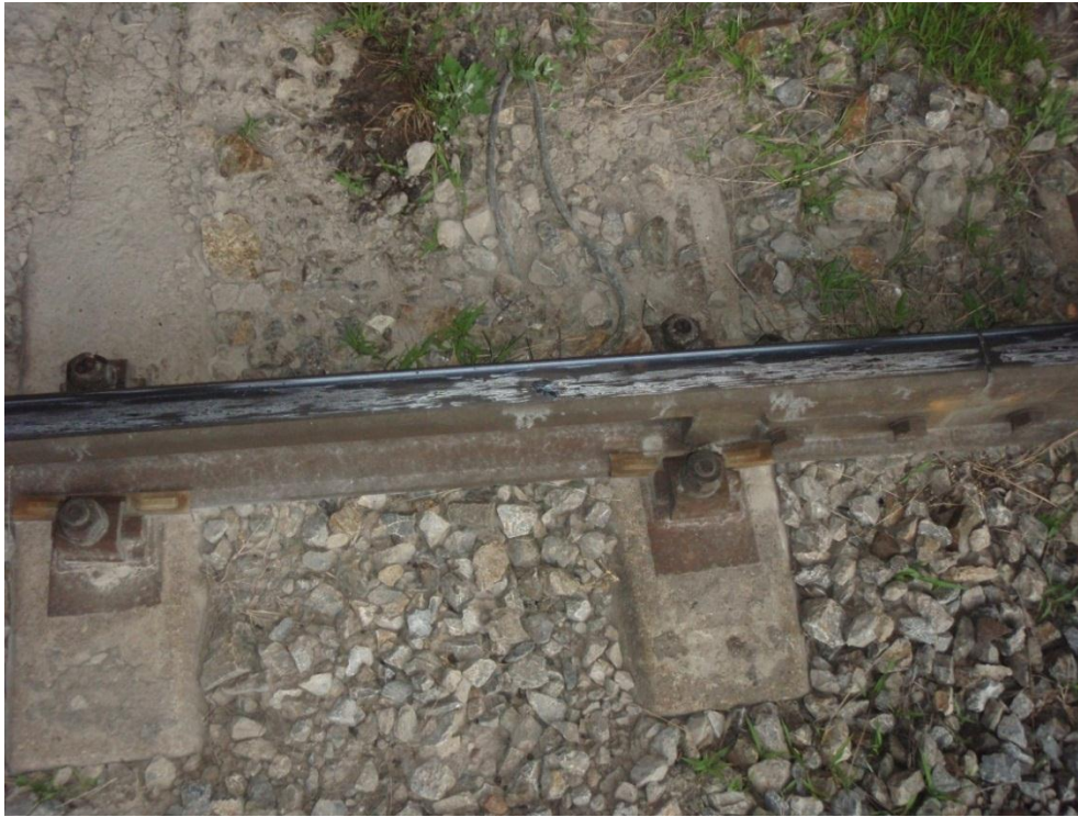
Abbildung 15 Spritzstoß im Bereich des Hemmschuh-Bremsweg unmittelbar nach dem Ereignis - Quelle IM
