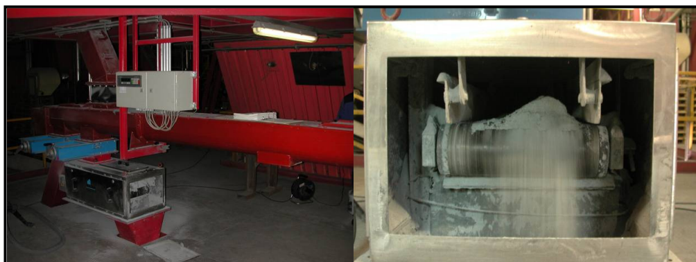
Abbildung 7: Asche-Bandwaage (Ermittlung der Aschemasse, Probenahmestelle für Asche)
