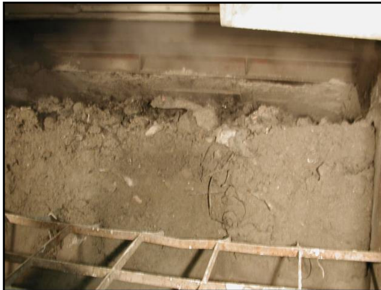
Abbildung 6: Nassentschlacker (Probenahmestelle für Schlacke)
