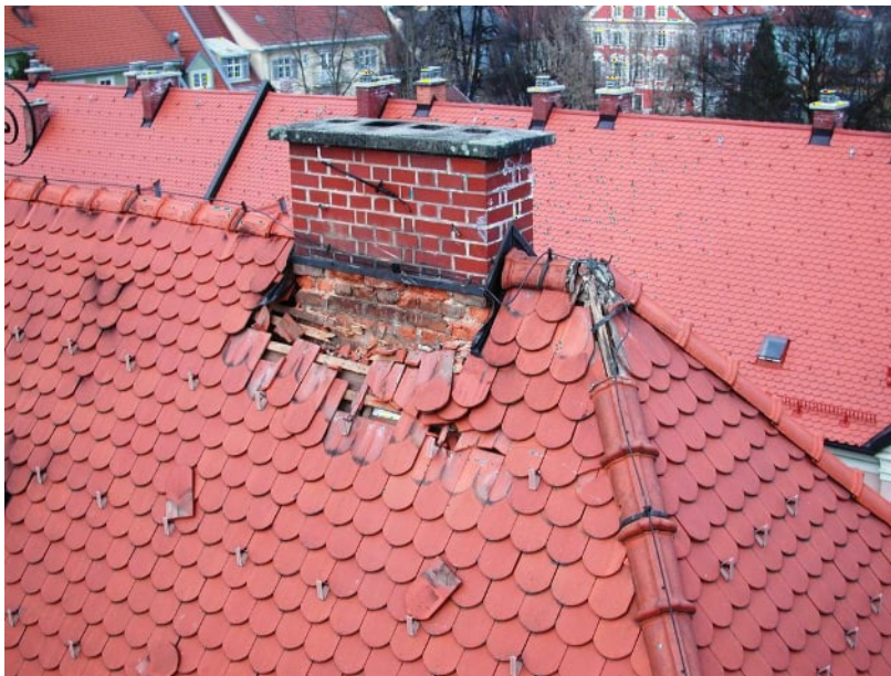
Abbildung 3 Beschädigung des Gebäudedaches und Kamin
