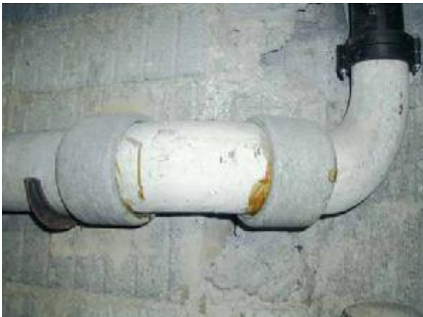
Foto 7: Abflussrohr aus Asbest (SUVAPRO 2007)
