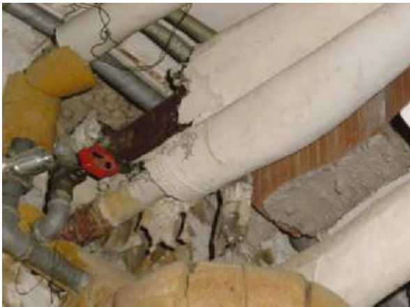
Foto 9: Asbestisolierung um Heizleitungen (SUVAPRO 2007)
