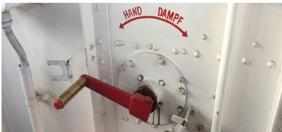
Abbildung 16 Betätigung der Klauenkupplung im Steuerhaus - Umschaltung auf Notsteuerung
