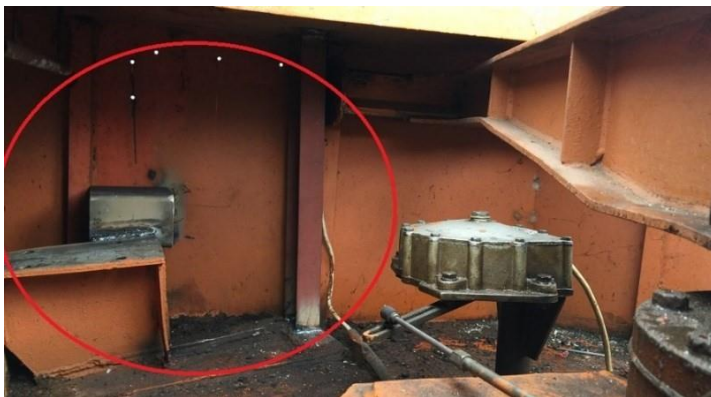
Abbildung 18 Ein Teil der Konsole des demontierten Endanschlags des linken Quadranten der "SCHÖNBRUNN"
