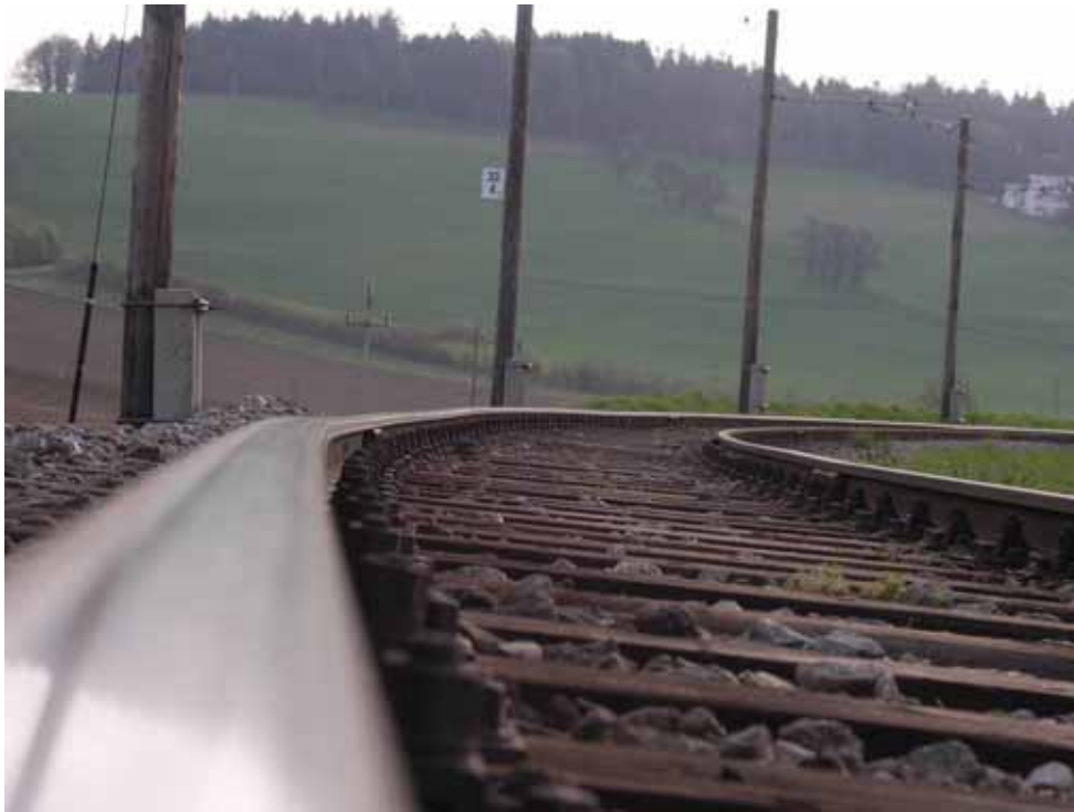
Abbildung 14 Gleis bei der Entgleisungsstelle km 33,430 - Quelle StH
