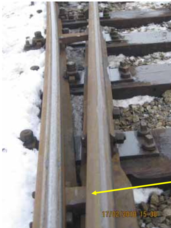
Abbildung 19 Aufsetzspur des Spurkranzes - Quelle StH
